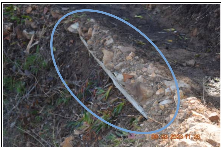
Autre vue de l'instabilité actuelle du terrain.
